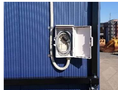
【外部入力用コンセント】
